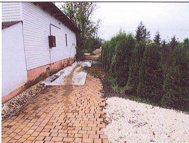
Zniszczona droga dojazdowa poniżej budynku na dz. nr .312
