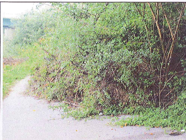
Czoło osuwiska wchodzące na drogę po terasie Dunajca ul. Nadbrzeżna.
