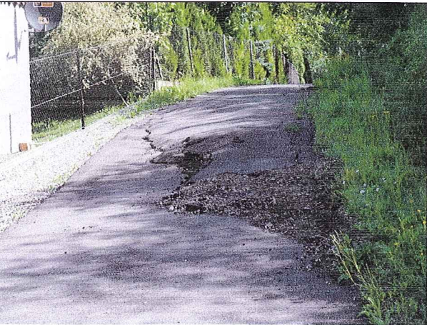
Zniszczony korpus drogi – ul. Olszyny.
