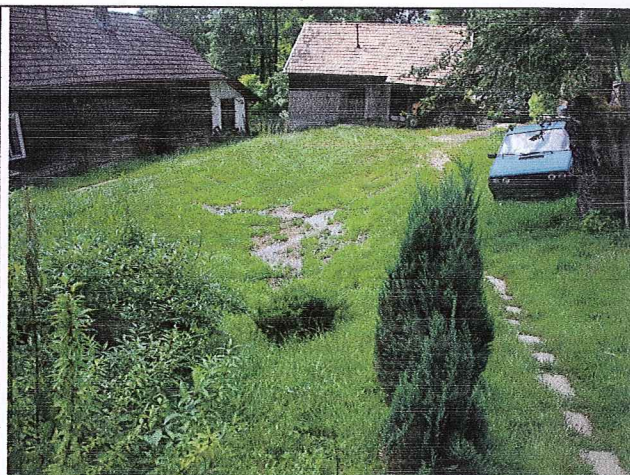
Wysięki wody z wtórnej niszy ponad starym budynkiem mieszkalnym.
