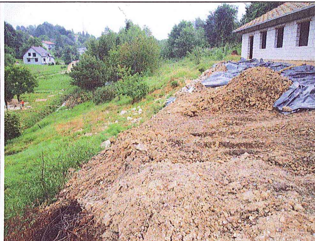
Skarpa główna zasypiana materiałem antropogenicznym przed nowobudowanym budynkiem mieszkalnym (dz. nr 314).
