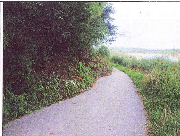
Czoło osuwiska wchodzące na drogę po terasie Dunajca (dz. ew. 507/6)
